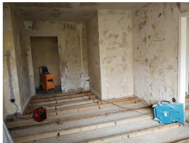
Vattenskadad lägenhet E-trappen, sommaren 2018
